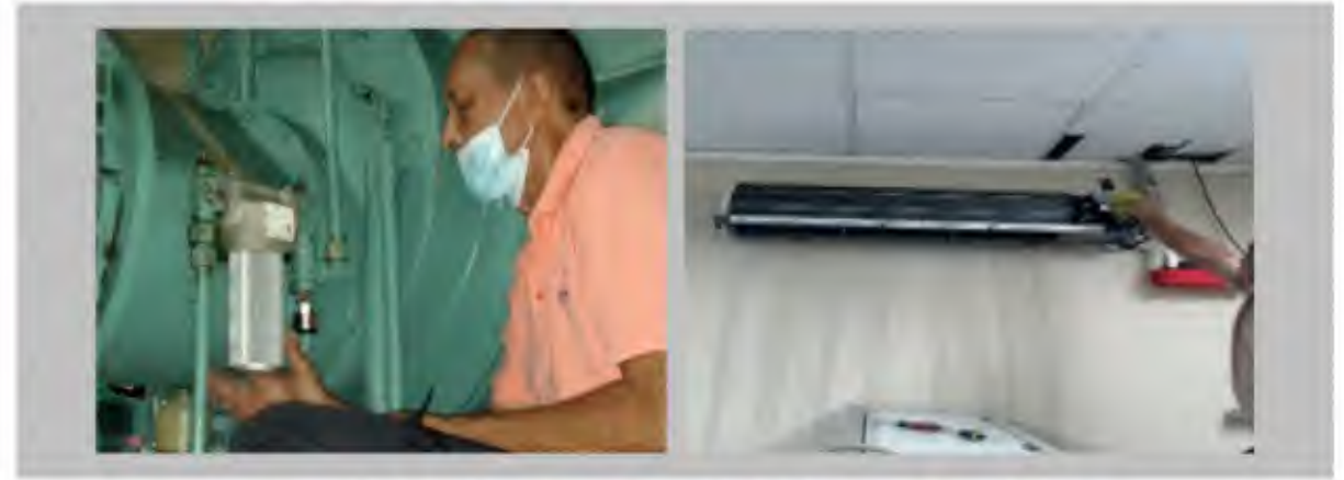
Mantenimiento de Chillers, Torres de Enfriamiento, Manejadoras, Bombas primarias y secundarias, sistemas de ventilación y otros equipos.
