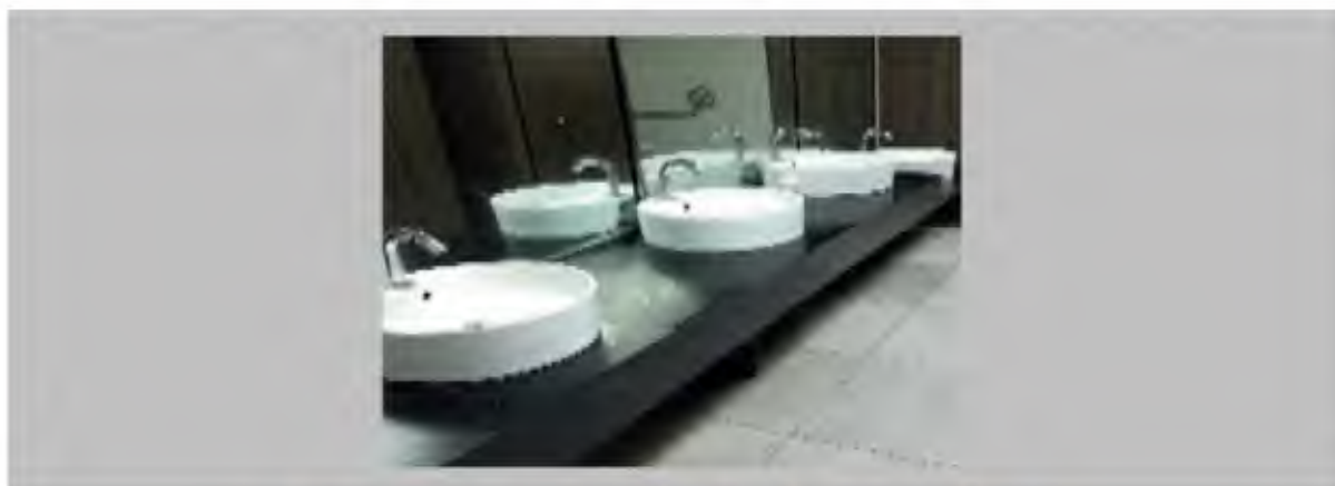
Mantenimiento a sistema de bombeo de aguas servidas, sistema de bombeo de agua potable y plomería en general.
